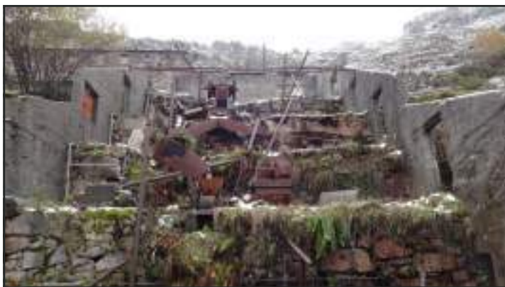
Figura 92. Vista interior del edificio desde su plataforma inferior. Se puede observar cómo el diseño aprovecha la pendiente, disponiendo cada máquina en un nivel diferente, permitiendo así un proceso muy eficiente.
